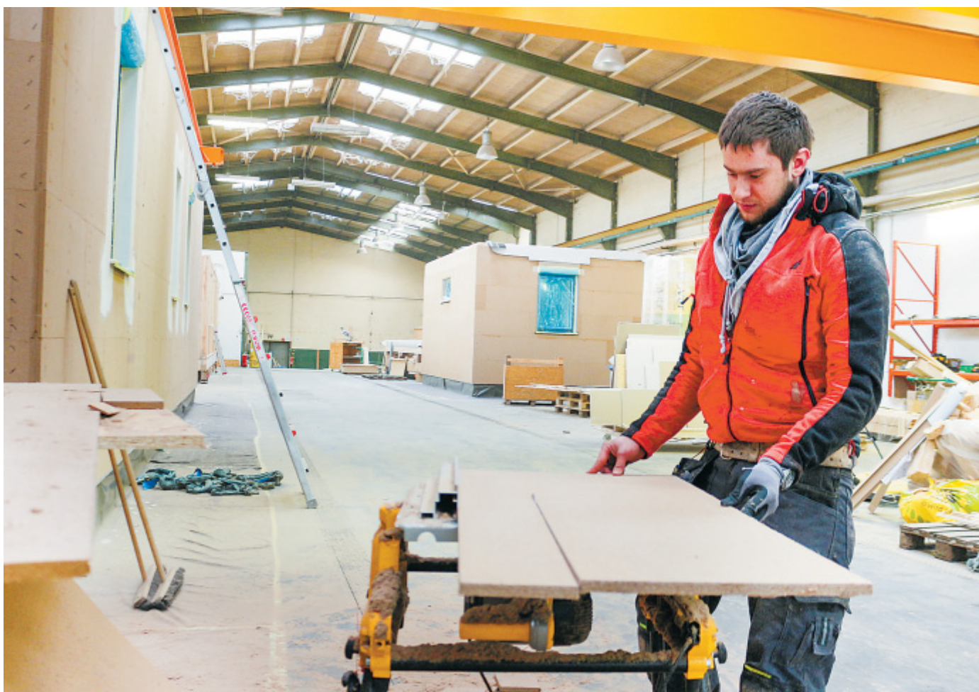
Vom Holzbrett zum Haus: Mateusz Zawilski sägt die Holzteile für ein Smart-House-Modul zurecht. In der Produktionshalle werden die Fertighäuser komplett aufgebaut und fertig zum Kunden geliefert. Vor Ort werden die Module dann zusammengesetzt.
